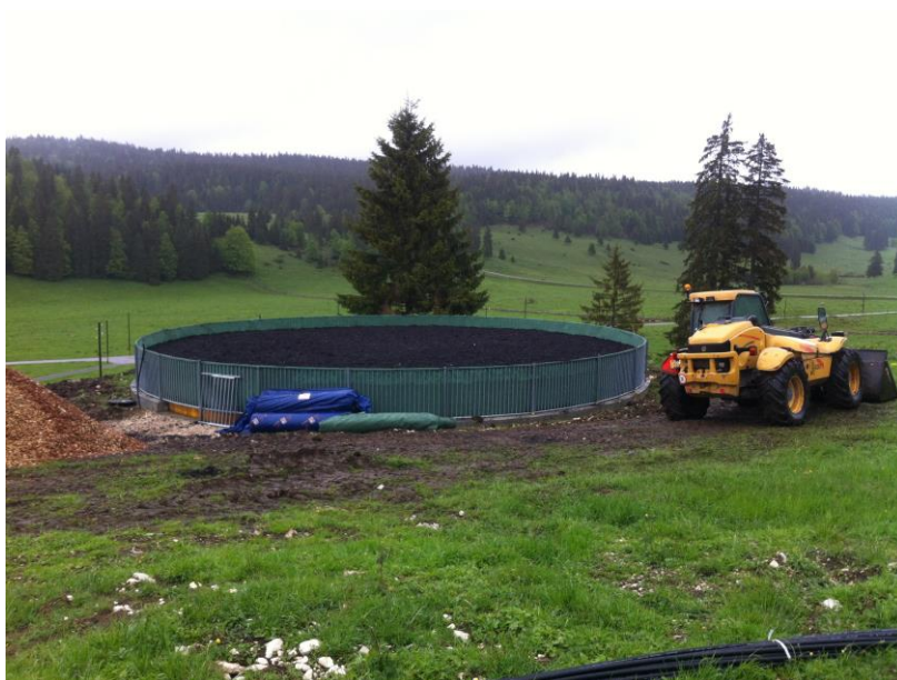
Remplissage de l'installation avec du compost
